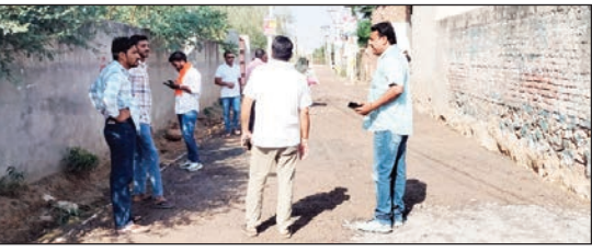
के लोगों को अनदेखी कर रहा है। नाली निर्माण के लिए छोड़ी जा रही जगह पर अपनी पहचान वालों के घर के सामने नाली की जगह छोड़ने की बजाए रोड़ी डालकर सड़क डालने का काम किया जा रहा है। सड़क का लेवल भी नहीं निकाला गया। जिससे कहीं पानी भरने और कहीं निचे खाली जगह होने के कारण जल्द टूटने की पूरी सम्भावना है। जिसका लोगों ने मंगलवार को विरोध किया। लोगों का कहना है कि एक तरफ नाली की जगह न छोड़कर ठेकेदार मनमाने ढंग से काम कर रहे हैं। जिसका बस्ती के लोग विरोध कर रहे हैं। विरोध कर रहे लोगों के बीच जाकर निवर्तमान पापद प्रदीप
